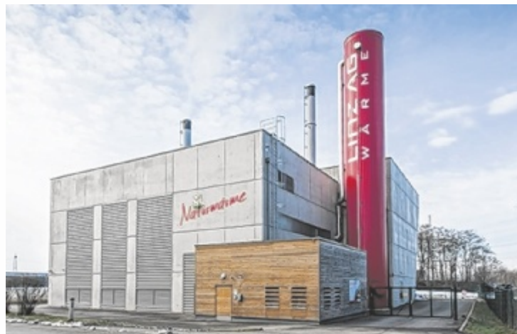
Die Marktgemeinde Asten sorgt für umweltfreundliche Naturwärme.
